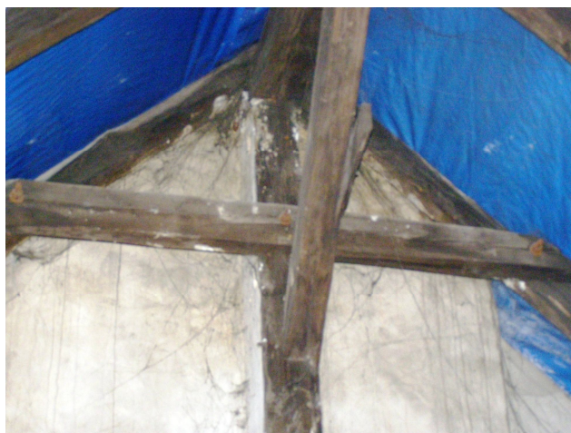
Foto. 12. Zawilgocenie więźby dachowej.
