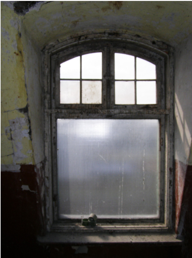
Foto. 10. Okno kuchni w lokalu nr 14.
