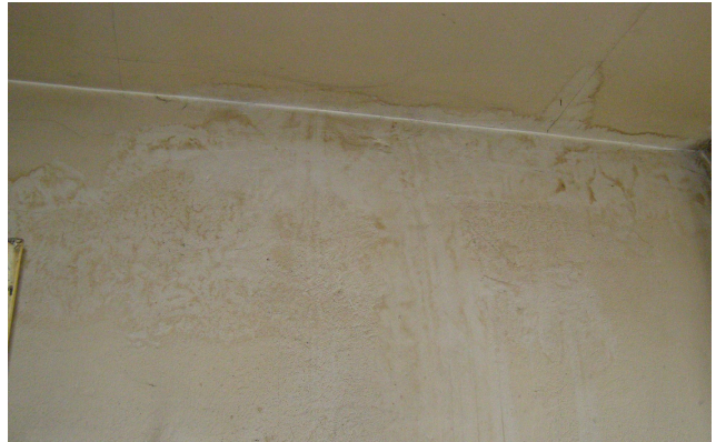
Foto. 31. Zawilgocenie płyt g.-k.(stropu lokalu 10).
