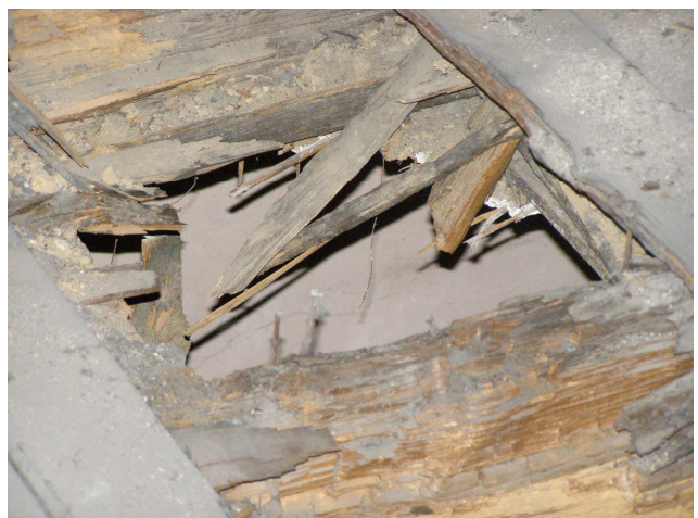
Foto. 25. Dziura w podłodze (strop lokalu nr 14).
