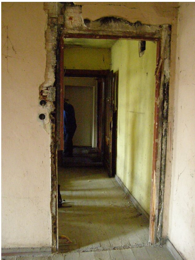
Foto. 35. Braki stolarki drzwiowej.
