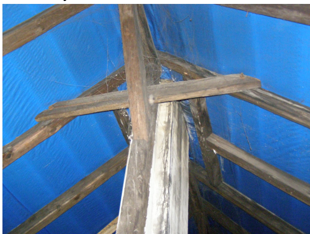
Foto. 13. Zawilgocenie więźby dachowej.
