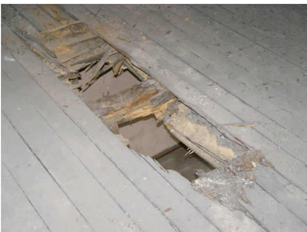
Foto. 24. Dziura w podłodze (strop lokalu nr 14)- widoczne ugięcie belek.
