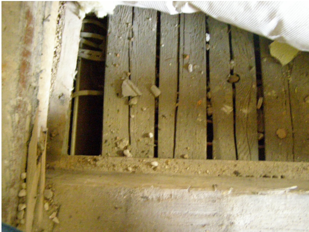
Foto. 30. Brak warstw stropu, widoczne instalacje
