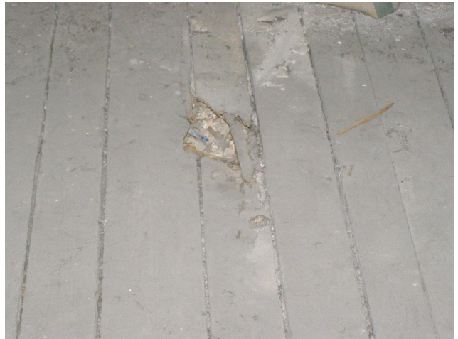
Foto. 27. Ubytki w deskowaniu.
