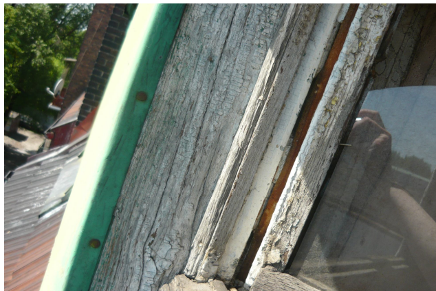
Foto. 36. Łuszczące się powłoki malarskie.
