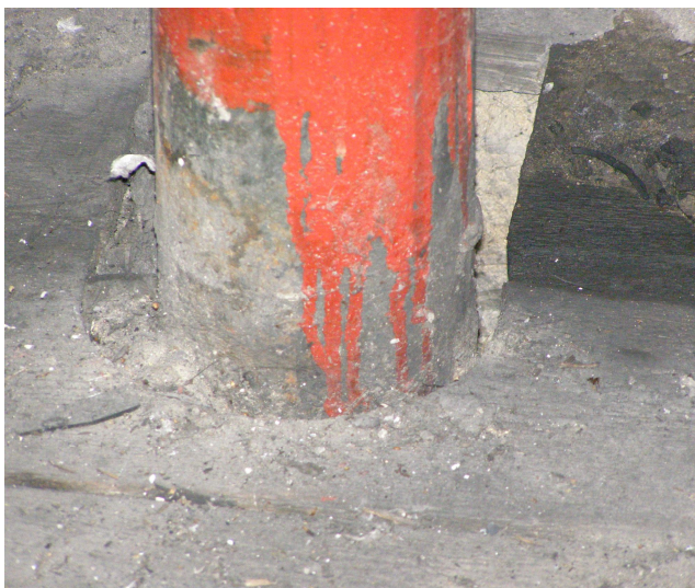
Foto. 40. Rura wentylacji na poddaszu.
