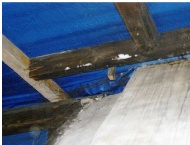
Foto. 14. Zagrzybienie i zawilgocenie więźby dachowej.
