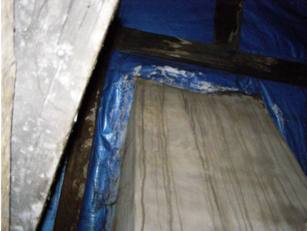
Foto. 22. Zacieki na kominie.
