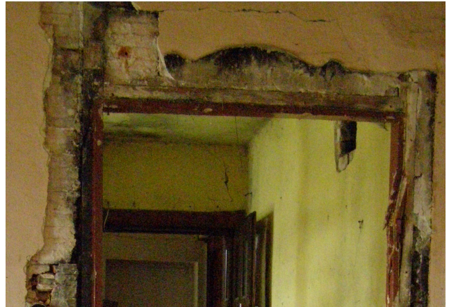
Foto. 20. Ubytki tynków i zawilgocenie ele. drewnianych.
